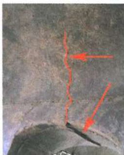
شکل ۲۰: ترک در قسمت بالای بازشو
