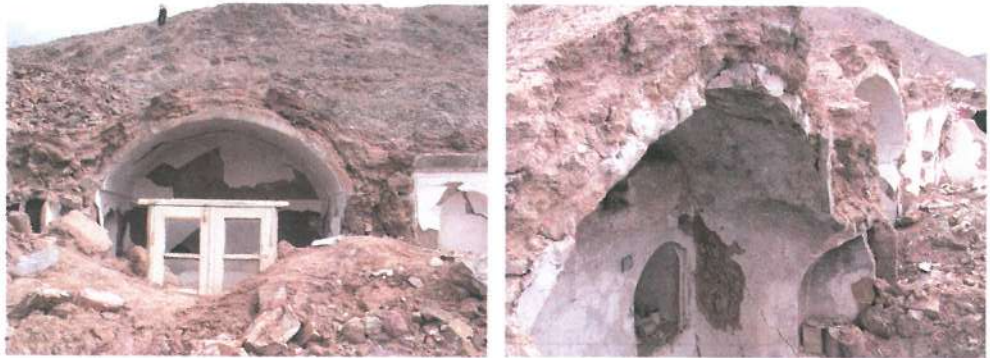
شکل ۳۴: سقف‌های طاق و لنگه که در زلزله داهوئییه-زرنند فرو ریختند
