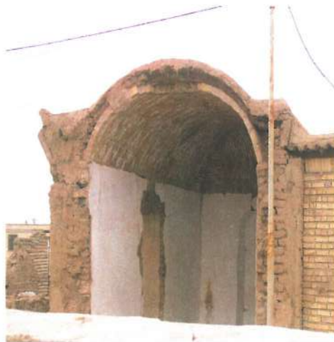
شکل ۲۶: خرابی دیوار جلویی - سقف سالم باقی مانده
