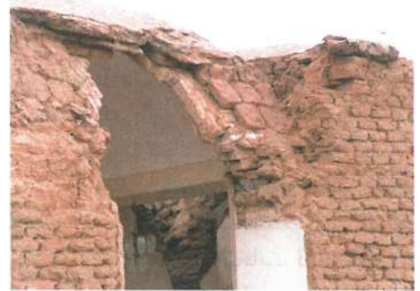
شکل ۲۴: فرو ریختن بخشهایی از سقف
