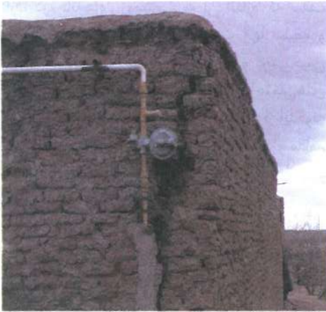
شکل ۱۱: ترک عمودی در محل اتصال دیوار به دیوار در اثر ضعف اتصال
