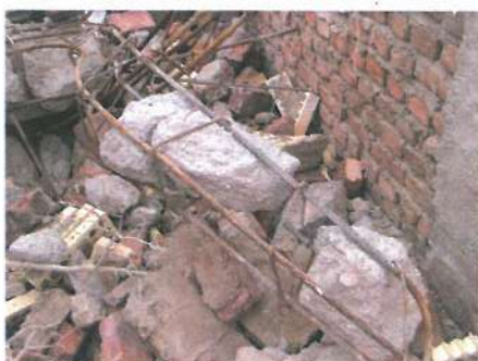
شکل ۱۷: استفاده از بتن نامرغوب
